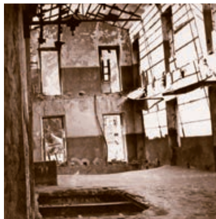
Zona interna opificio danneggiato a Fara San Martino
